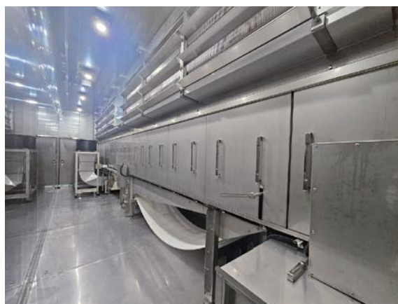
トンネル式フリーザーの外観
